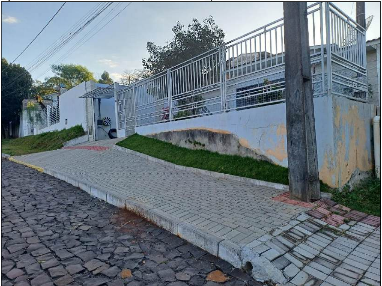
Figura 37 – Declividade transversal superior à 3% na calçada da rua Itaberaba
