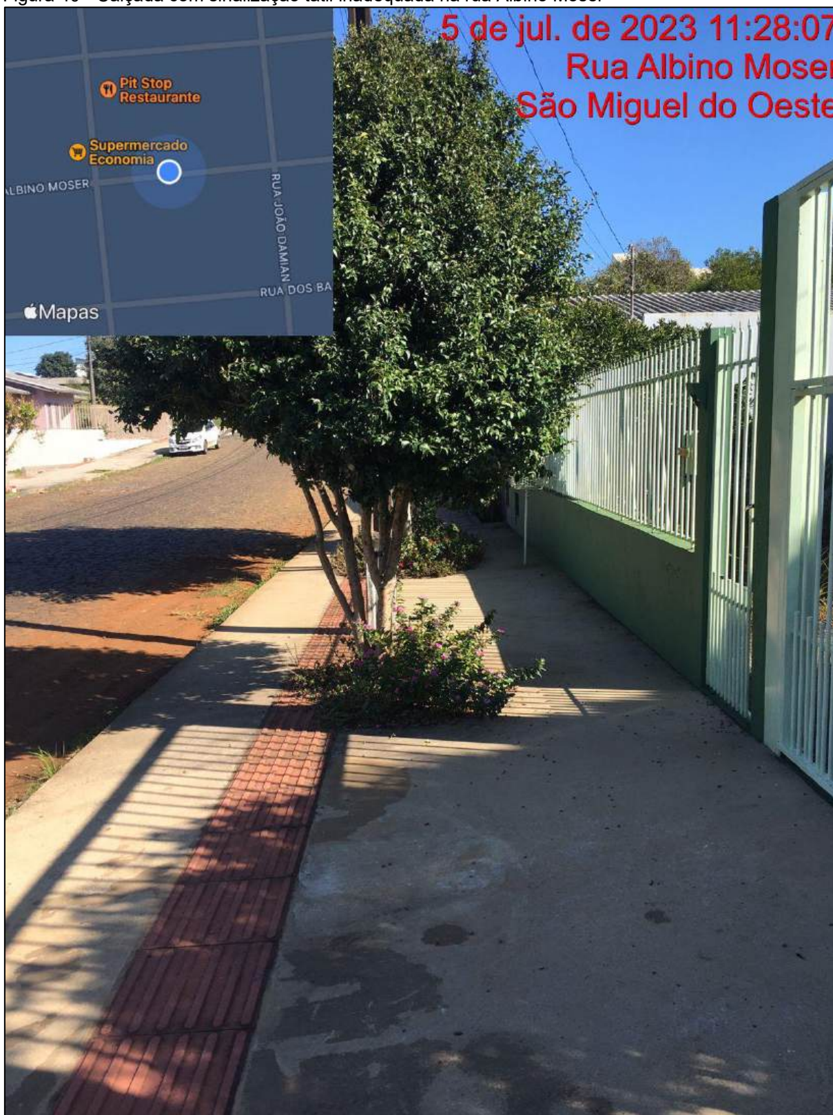
Figura 40 - Calçada com sinalização tátil inadequada na rua Albino Moser
